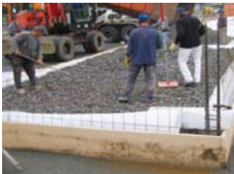
▲ Verteilung des Glasschaumgranulats mit Rechen
